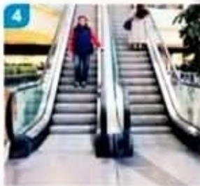
مصعد كهربائي escalator
